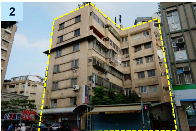
房屋傾斜，建物結構不符耐震標準
