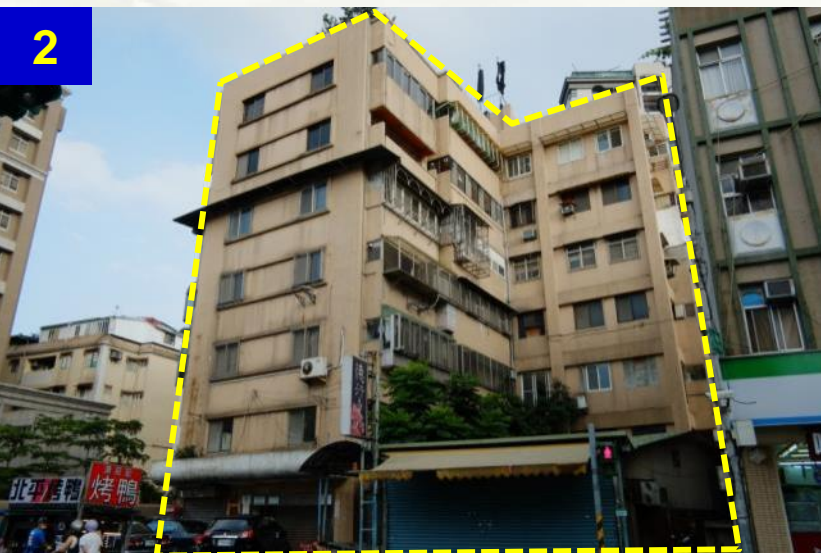
房屋傾斜，建物結構不符耐震標準
